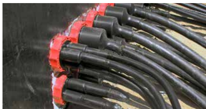
Stationuitvoering : Laagspanningskabel afgedicht met HSI 90-D1/75 en HSI 90-D3/32
