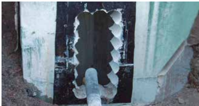
Hoogspanningskabels en beschermbuizen moeten naderhand in schachtwacht worden afgedicht
