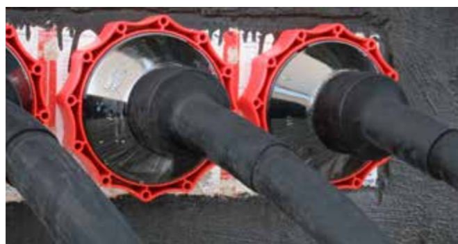
Doorvoering in station: Laagspanningskabel met HSI-D1/80
